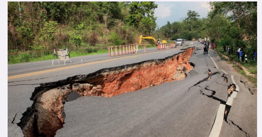
Kerosakan Jalan Utama Kesan Daripada Gempa Bumi
