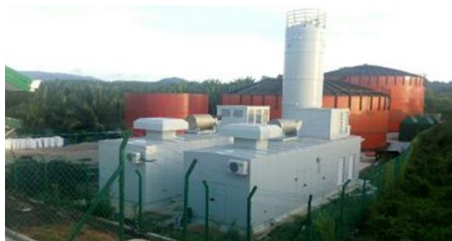
Sistem Generator Biogas 2 MW di Kahang oleh FELDA Palm Industries Sdn Bhd untuk memproses bahan buangan kelapa sawit bagi menghasilkan tenaga elektrik.
