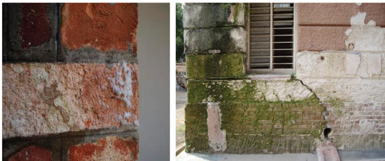
Foto 45: Contoh kerosakan di bangunan warisan seperti penggaraman pada permukaan dinding yang berlaku akibat penggunaan simen portland pada dinding lepaan kapur (kiri) serta tumbuhan lumut yang tumbuh pada permukaan dinding bangunan (kanan).
