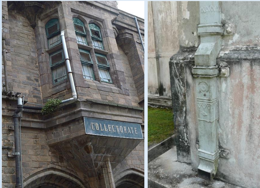
Foto 49: Contoh pemasangan saluran paip air yang tidak harmoni dengan bangunan warisan (kiri) dan saluran air asal boleh dikekalkan bagi tujuan estetika (kanan).
