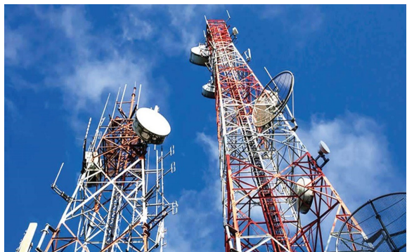
Contoh Pemasangan Menara Telekomunikasi Sumber : Menara Telekomunikasi, Laman Sesawang Bernama https://www.bernama.com/
