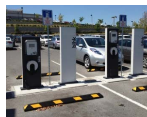
Foto : Stesen Pengecas Kereta Elektrik
