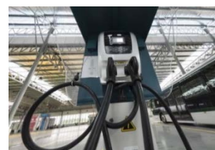
Foto : Stesen Pengecas Bas Elektrik
