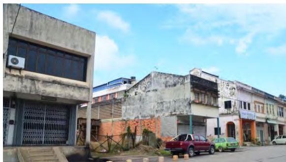
Foto: Struktur bangunan yang perlu diperbaiki untuk mengekalkan keindahan struktur asal
