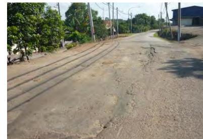
Foto: Keadaan jalan berturap di Kg. Tiong yang tidak rata serta berlubang perlu dibaiki demi keselamatan dan keselesaan penduduk setempat
