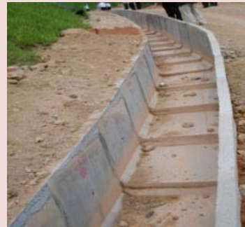
Longkang utama untuk melepaskan air ke sungai berhampiran atau lembangan sedimen.
