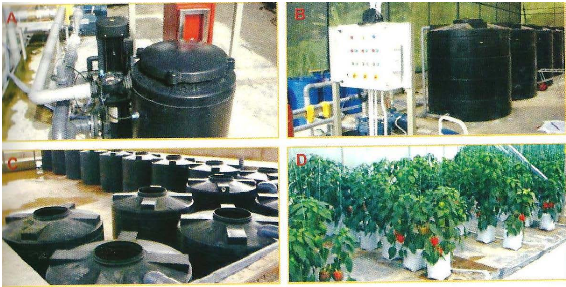
Sistem kitar semula air hujan yang digunakan dalam sistem fertigasi
