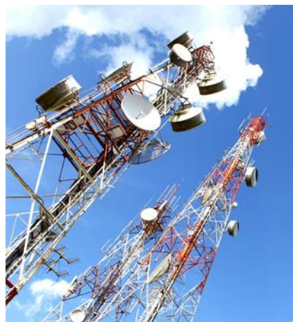
Gambaran menara pemancar telekomunikasi
