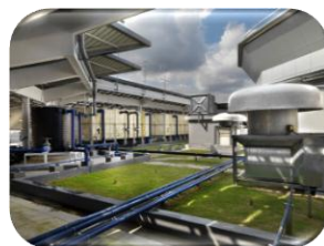
Contoh SPAH di Bangunan Suruhanjaya Tenaga
