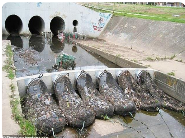
Contoh pemasangan perangkap sampah di kawasan industri dan perumahan
