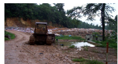
Mengantikan kaedah open dumping kepada kaedah rawatan sanitary landfill
