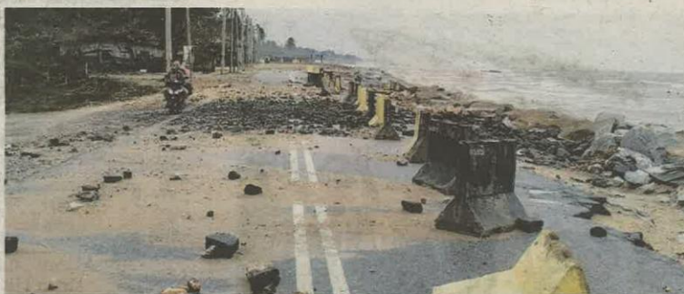
JALAN Pantai Mengabang Telipot, Kuala Nerus terpaksa ditutup kepada semua jenis kenderaan kerana risiko runtuh akibat fenomena ombak besar yang melanda Terengganu ketika ini. - UTUSAN/KAMALIZA KAMARUDDIN
